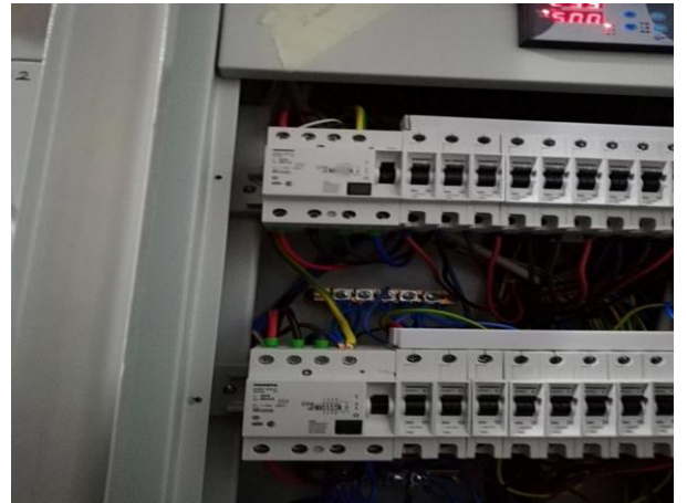
Resim 6 ŞALT BAĞLANTILARI VE İÇ KABLO TESİSİ_04
