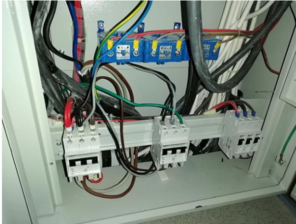
Resim 3 ŞALT BAĞLANTILARI VE İÇ KABLO TESİSİ_01
